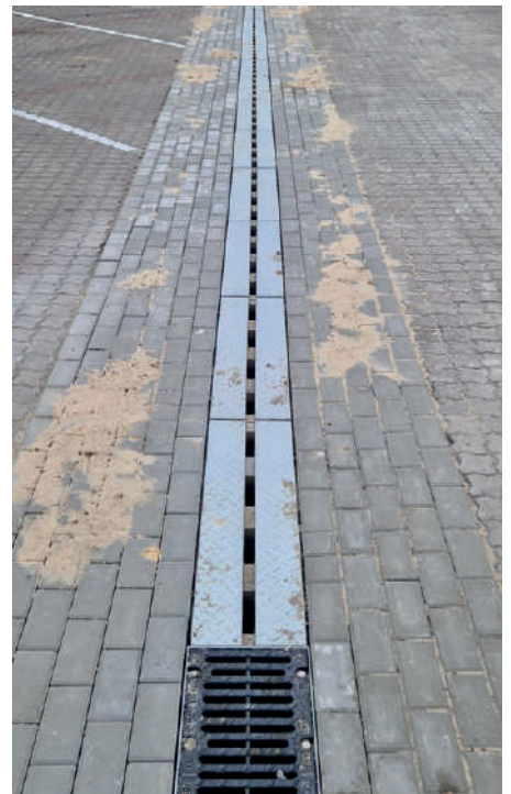
Centra logistyczne Bydgoszcz AS-S150R
