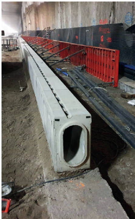
Tunel S2 Warszawa AS-S200 K-T
