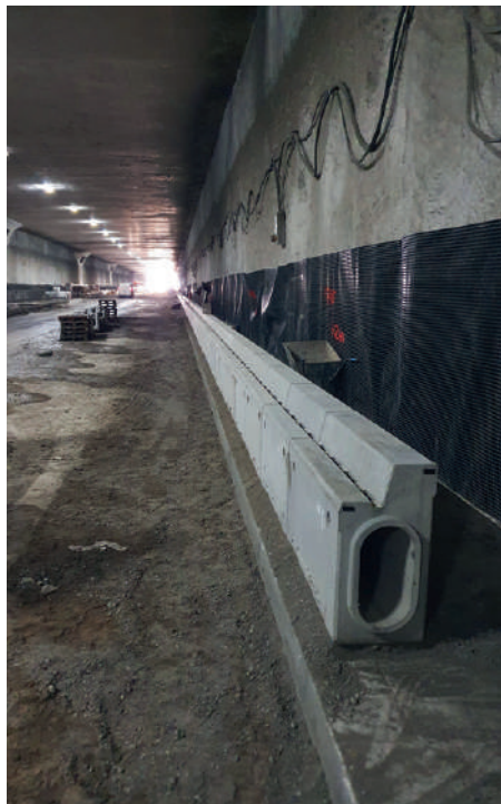
Tunel S2 Warszawa AS-S200 K-T
